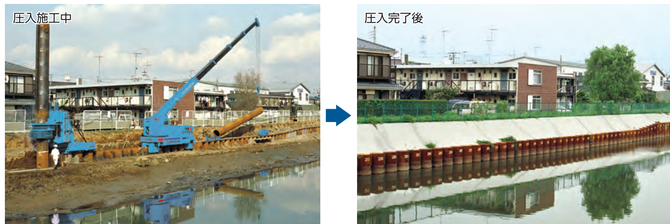
地球と杭が一体となったインプラント構造®の護岸を仮設レス施工で構築
