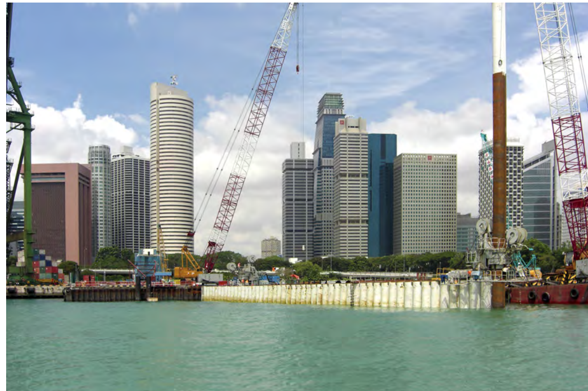
高速道路新設に伴う鋼管矢板二重締切護岸工事(シンガポール)
